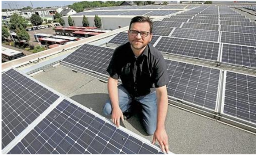
Die Wupsi-Solaranlage auf dem Dach der Halle in der Fixheide hat sich laut Technikchef Matteo Christofaro bewährt. (Foto: Michael Wand)
